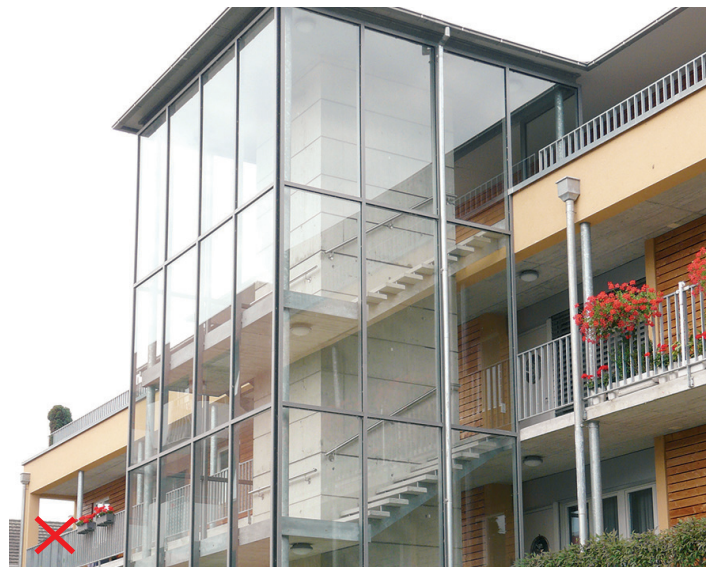
Abbildung 17: Dieses Treppenhaus bietet viel Durchsicht – für Vögel eine Gefahr. Zu markieren wären vorab die seitlichen Elemente. © Archiv Schweizerische Vogelwarte
