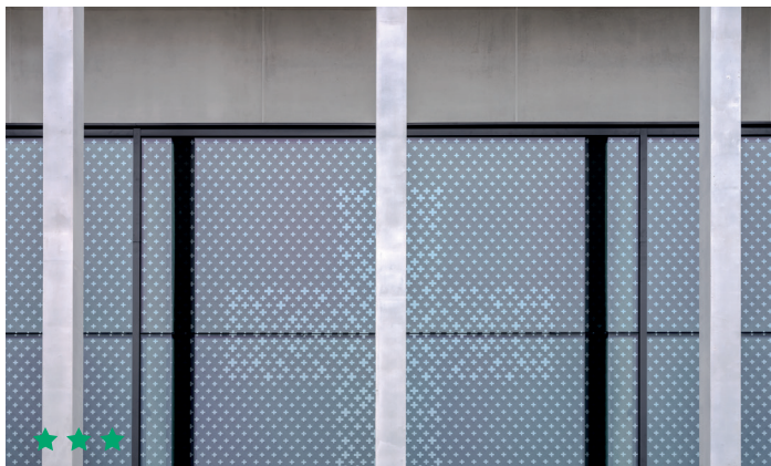
Abbildung 8: Eine vorbildliche Umsetzung findet sich auch auf dem Waffenplatz Frauenfeld: die Glasfront des Verpflegungszentrums ist mit einem Muster versehen, womit Vogelkollisionen vermieden werden können. © René Dürr
