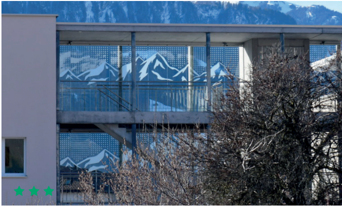
Abbildung 12: Verglaste Verbindungstrakte sind klassische Vogelfallen. Dieses Altersheim hat mit dieser dekorativen Lösung vorbildlich nachgerüstet. © Christoph Meier-Zwicky
